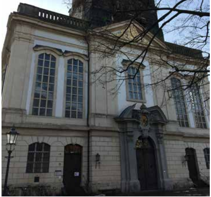
Die renovierungsbedürftige Westfassade der Dreikönigskirche.
